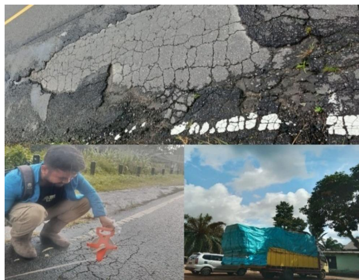
Gambar 1. Kerusakan Jalan Sumber: Dokumentasi Lapangan
