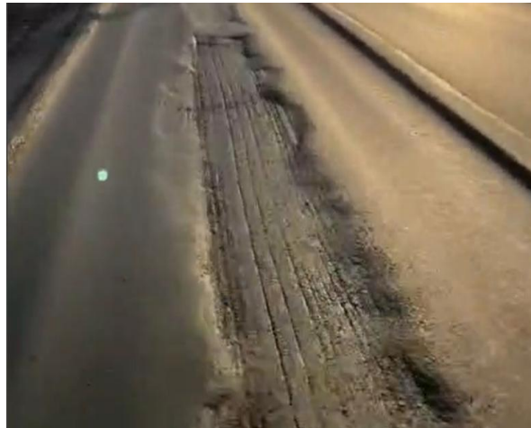
Gambar 3. Permukaan licin/terpolish dengan jejak deformasi memanjang pada wheel path Sumber : Data Peneliti, 2025
