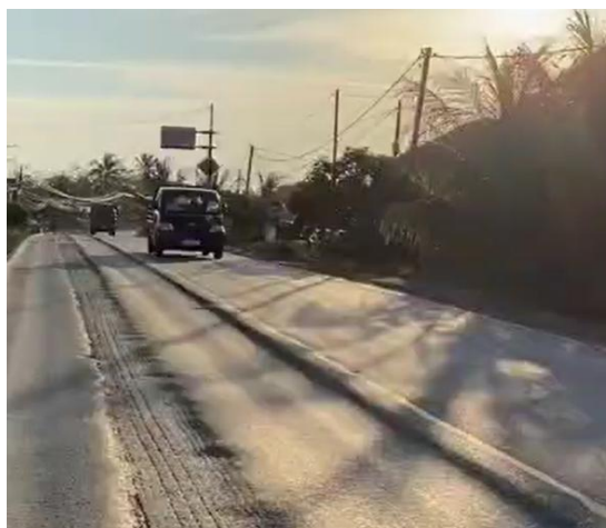
Gambar 2. Kondisi wheel path dengan alur memanjang ( rutting ) dan gelombang Sumber : Data Peneliti, 2025
