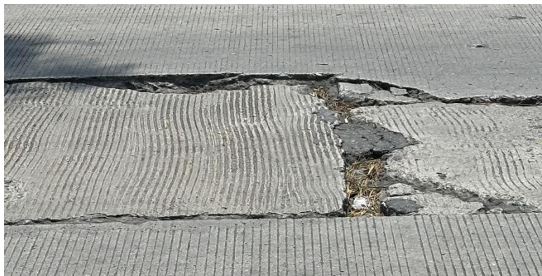
Gambar 2. Tingkat kerusakan retak sudut, ruas jalan raya bandar buat STA 02+000-STA 07+000 (Sumber : Prayitno E, Universitas Bung Hatta, 2024)
