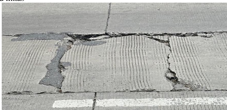
Gambar 4. Tingkat kerusakan retak akibat beban lalu lintas, ruas jalan raya bandar buat STA 02+000-STA 07+000 (Sumber : Prayitno E, Universitas Bung Hatta, 2024)
