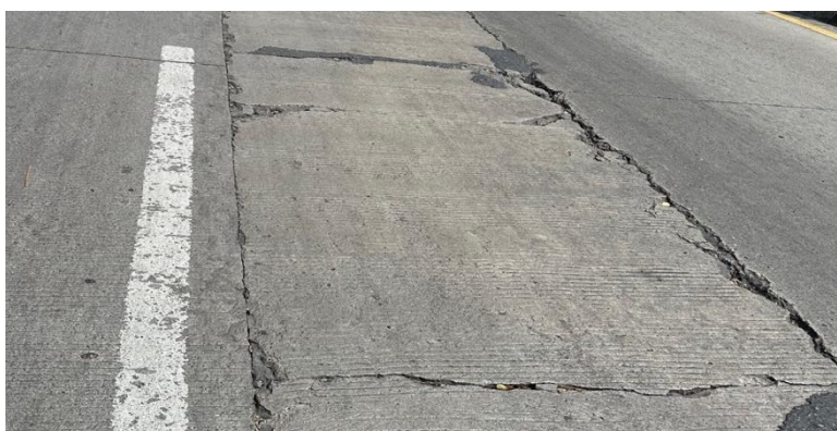
Gambar 3. Tingkat kerusakan slab terbagi oleh retak, ruas jalan raya bandar buat STA 02+000-STA 07+000 (Sumber : Prayitno E, Universitas Bung Hatta, 2024)
