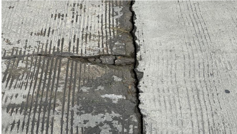
Gambar 5. Tingkat kerusakan penurunan bagian bahu jalan, ruas jalan raya bandar buat STA 02+000-STA 07+000 (Sumber : Prayitno E, Universitas Bung Hatta, 2024)
