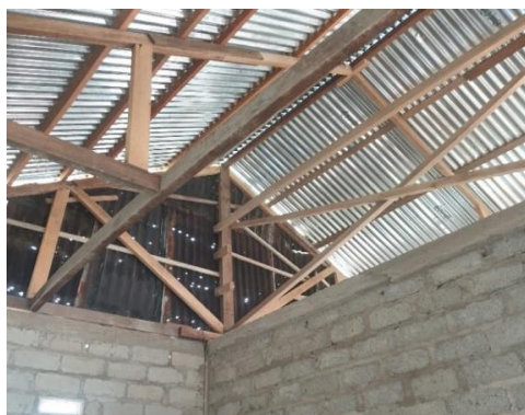
Gambar 7. Rumah salah satu penerima bantuan yang rangka atap dan atapnya telah selesai dikerjakan.
