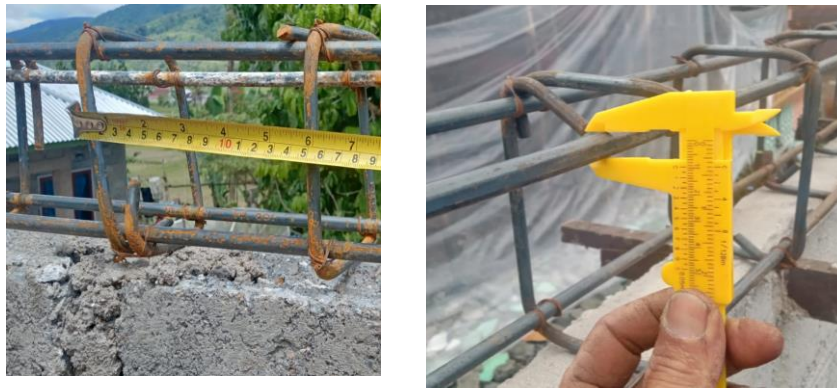
Gambar 5. Diameter tulangan dan jarak sengkang pada sloof dan ring balok Sumber: Pangestu. Y, 2023 (Dokumen Pribadi)
