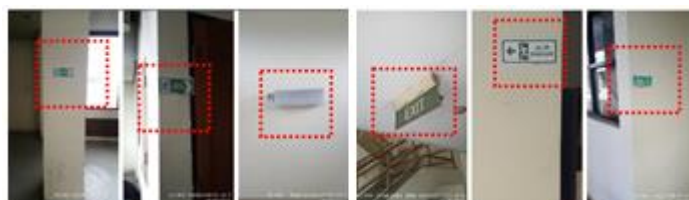
Gambar 35. Kondisi Signage Jalur Evakuasi Gedung PAU ITB
