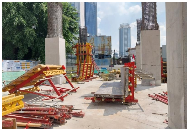
Gambar 4 : Ketidaksesuaian Penempatan Bekisting
