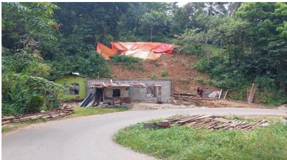
Gambar 3. Bangunan terdampak bencana tanah longsor 01 april 2023 di desa Kubang Tengah
