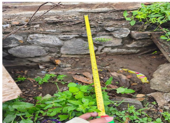
Gambar 2 : Kondisi Drainase Sumber: Dokumen Pribadi Survey Lapangan
